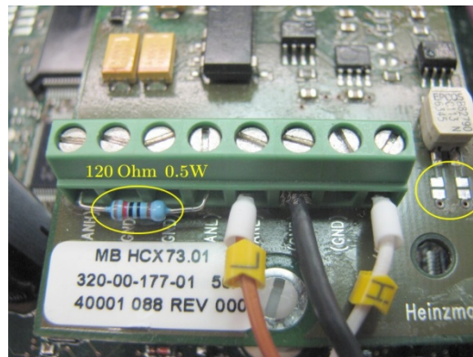
Abbildung 17: DC 2 mit HCX73.01, Terminierung
