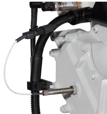
Pick-up an Motor installiert
